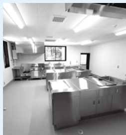
I・H・ガス共使用可能な調理室
